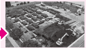
6月には、根切り工事や捨てコン打設などの基礎工事を開始しました。
