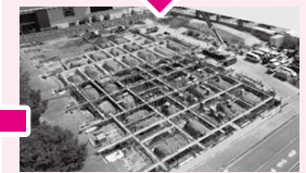
7月には、建物を支える基礎となるコンクリート打設工事を行いました。
