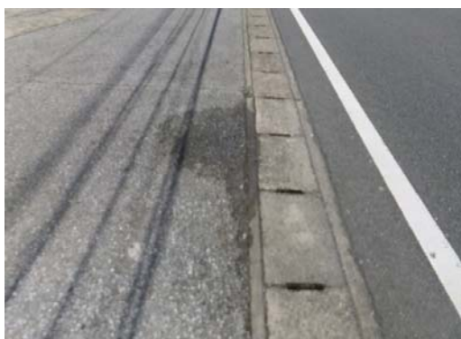
《上蒲生地内での漏水》
