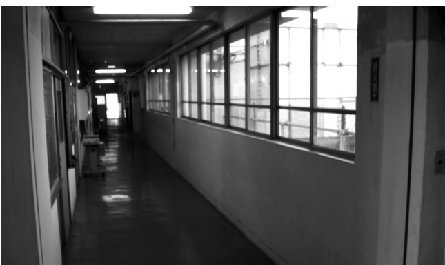
風雨時に雨水が入り込む本郷中学校廊下
