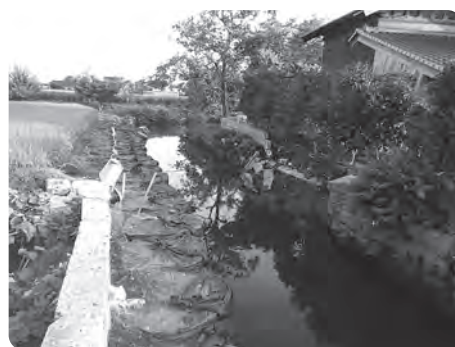
大雨で崩れてしまった井川の護岸
