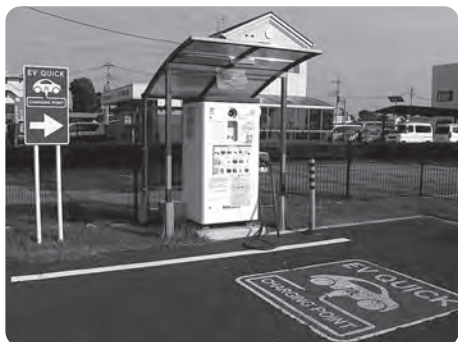
電気自動車用急速充電器 (いきいきプラザ敷地内)
