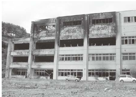
津波と火災にあった大槌小学校
